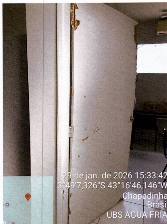
Imagem 15 – Portas de madeira danificadas.
