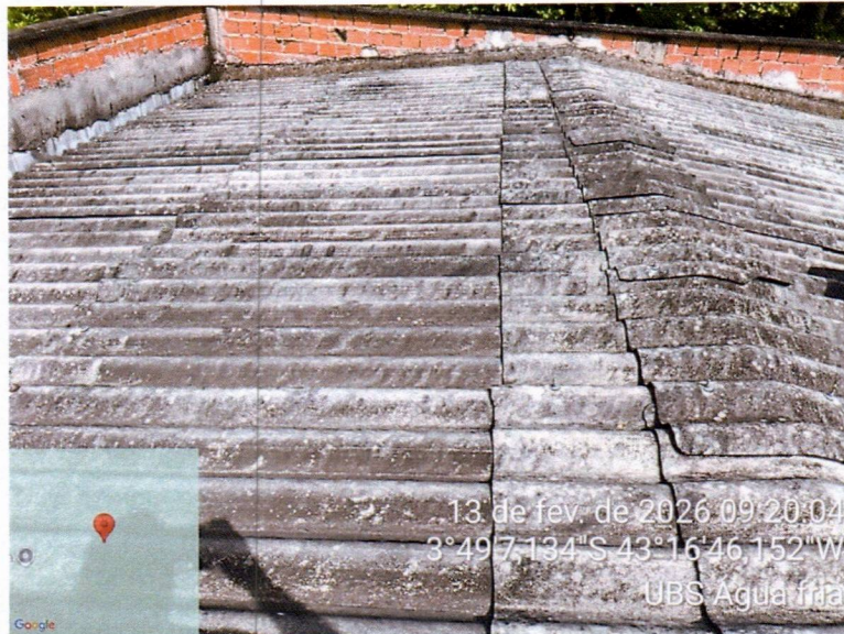
Imagem 17 – Telhamento com telha de fibrocimento danificados, apresentando rachaduras.
