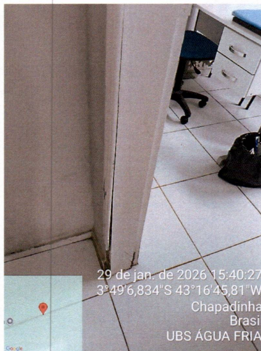
Imagem 14 – Portal das portas de madeira danificados.
