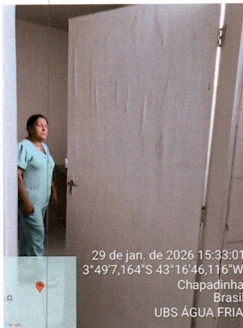
Imagem 13 – Portas de madeira danificadas.
