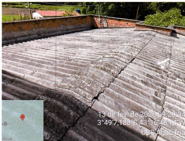
Imagem 18 – Telhamento com telha de fibrocimento danificados, apresentando rachaduras.
